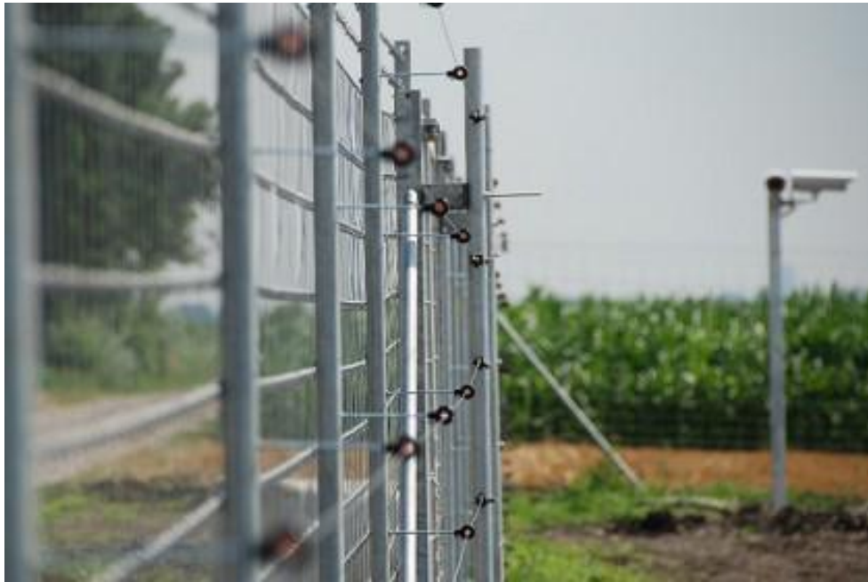
Rysunek 4 Przykładowe ogrodzenie farmy fotowoltaicznej
