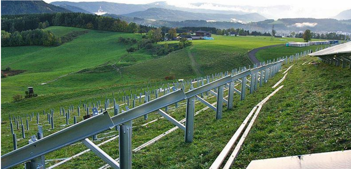
Zdjęcie 6 Konstrukcja przeznaczona do posadowienia paneli fotowoltaicznych.
